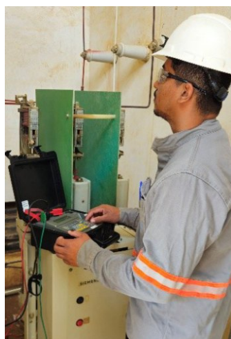
Manutenção Preventiva Cubículos Elétrico – Área F
