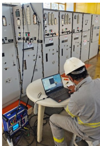
Testes Elétricos Estação ER-C2
