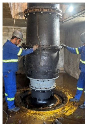
Manutenção Mecânica Bomba KSB – Estação ER-C2
