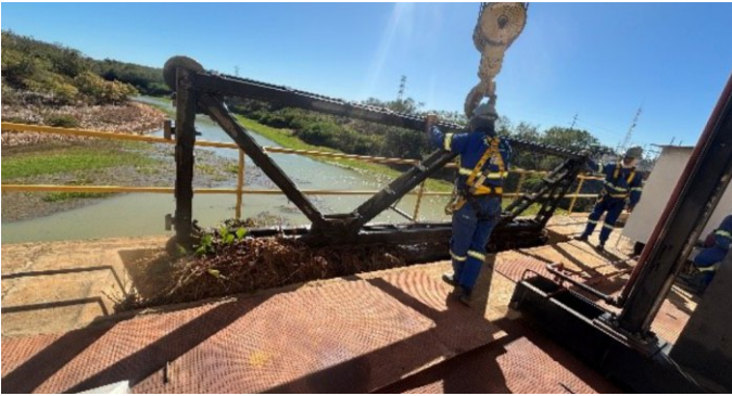
Limpeza grades da sucção das bombas da Estação EB-1
