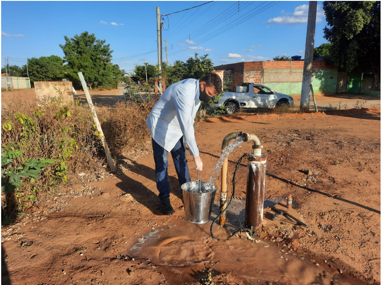
No poço profundo Núcleo Habitacional NH-1, Gleba F
