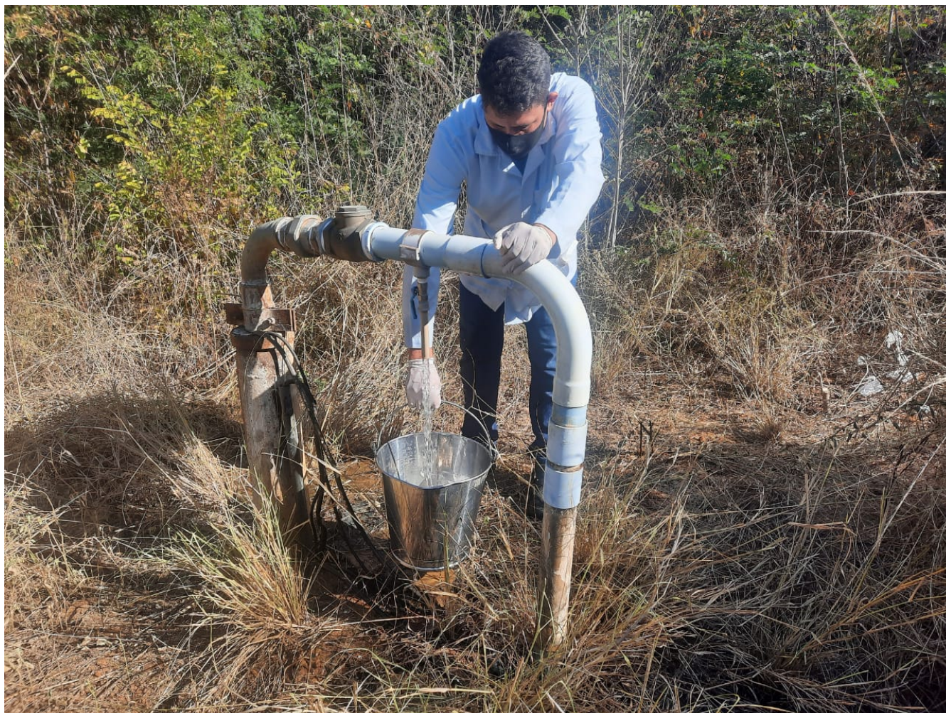
No poço profundo do Núcleo de Serviço NS-1/B, Gleba B
